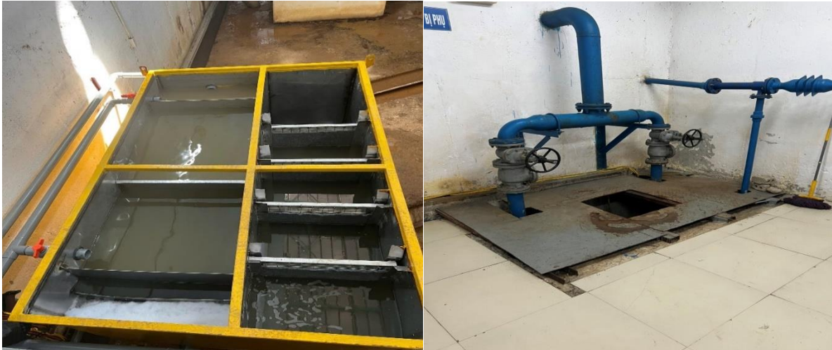
Hình 15: Bể hợp khối tách dầu và bể chứa nước rò rỉ
