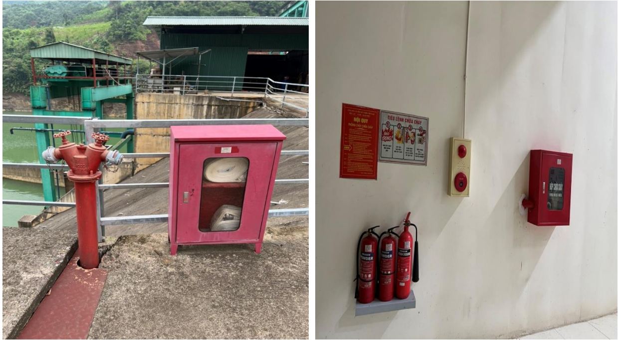
Hình 17 Hệ thống chữa cháy tại cơ sở
